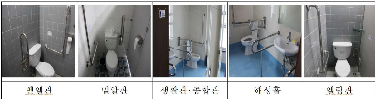
[사진 4.3.2-14] 각 건물 위생시설
