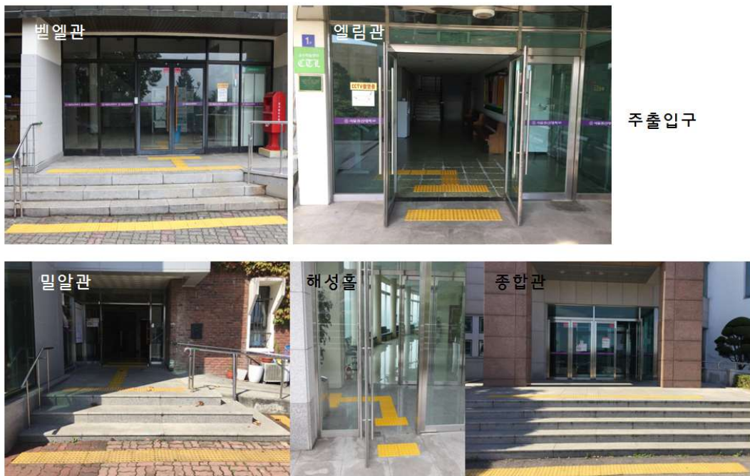
[사진 4.3.2-10] 건물 출입구 시각장애인 유도블록
